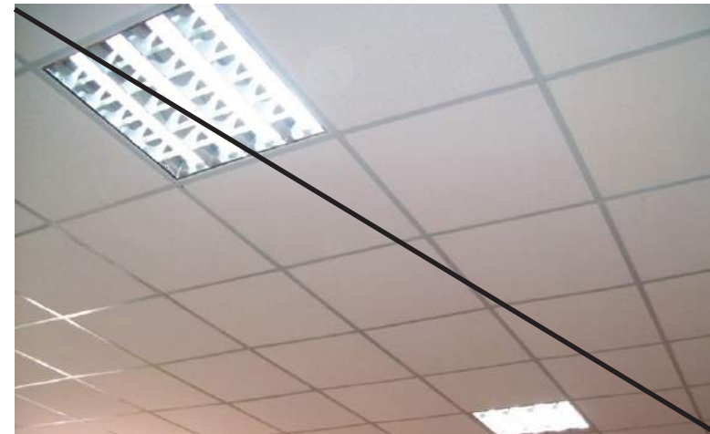
Плохо Открытые направляющие
