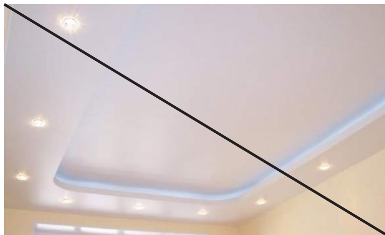
Плохо Многоуровневые гипсокартонные конструкции
